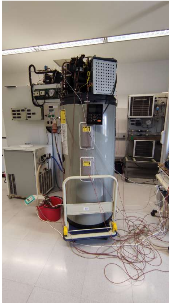
Figura 2.1: Aerotermia y enfriadora antes de las modificaciones
