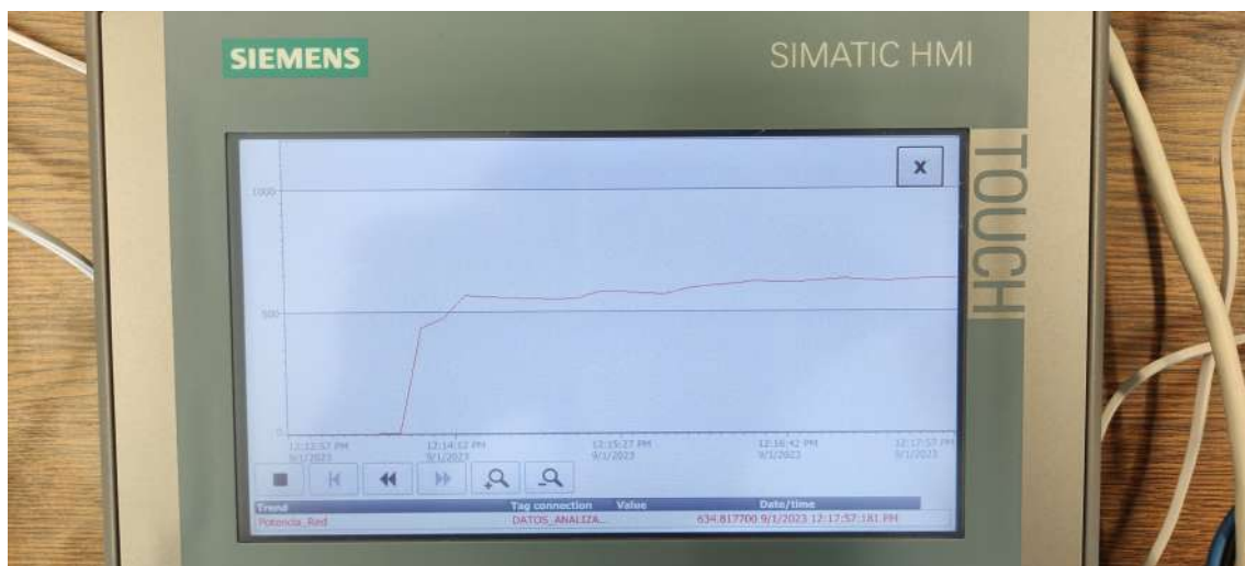
Figura 8.9: Potencia activa de la aerotermia.
