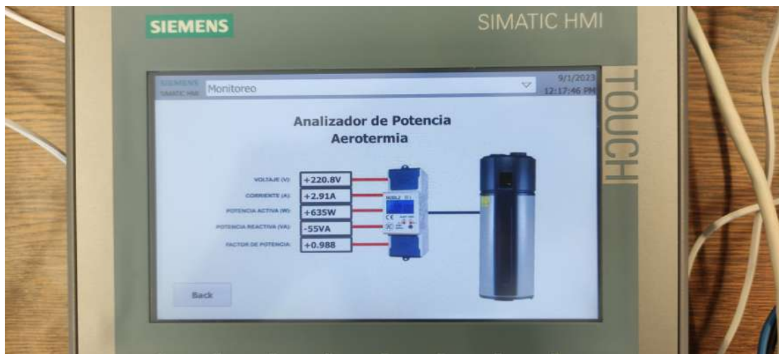
Figura 8.8: Analizador de de Potencia Aerotermia.
